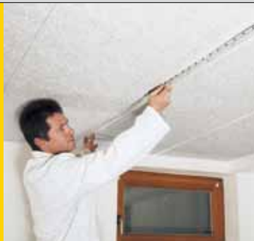
Verbesserung des Deckenbildes durch nachträgliches Einklemmen von Tragschienen eines Schienen-Systems bei der Klebemontage (durchgehende Längsfugen notwendig)
